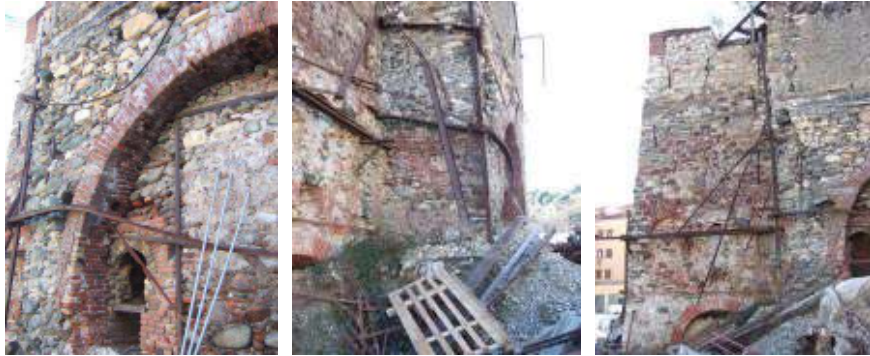
Figg. 2, 3, 4. Fasciature storiche, inefficaci, sul lato nord.
