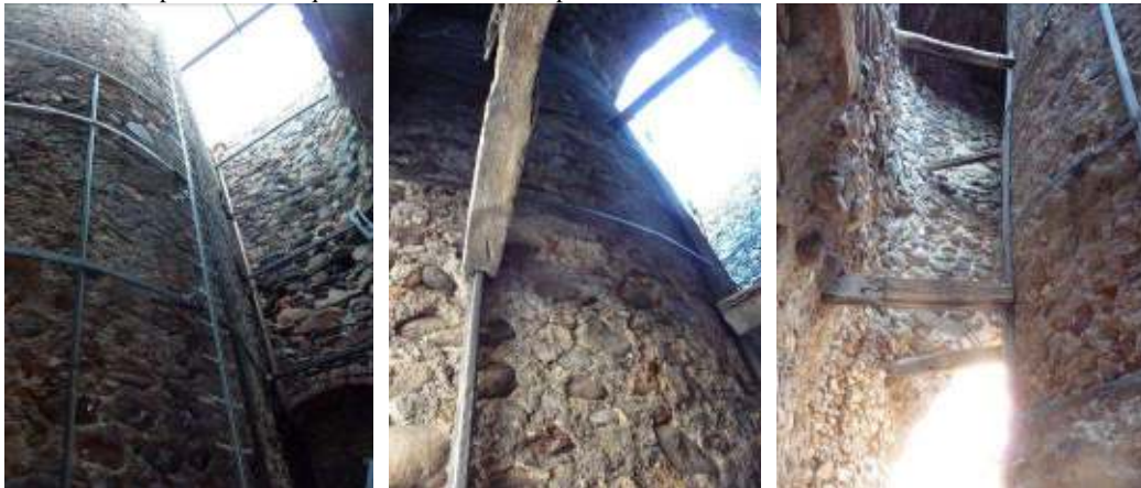
Fig. 9, 10, 11. Anche il camino vero e proprio della fornace più antica (corpo A) presentava una serie di cerchiature in ferro con puntelli in legno, aggiunte a più riprese negli anni (le ultime, addirittura, erano costituite dai vecchi binari non più utilizzati). Queste sono state conservate, fissate meglio alla muratura ove necessario, e trattate con il convertitore di ruggine.
